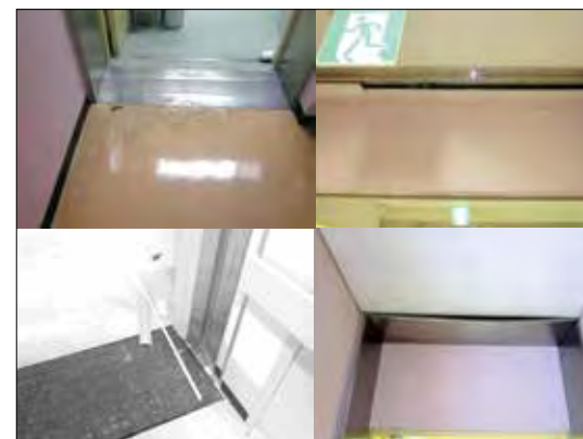
これは病棟と周産期センターのつなぎ目の廊下の状況です。天井がゆがんでいます。天井の一部が落下しました。
