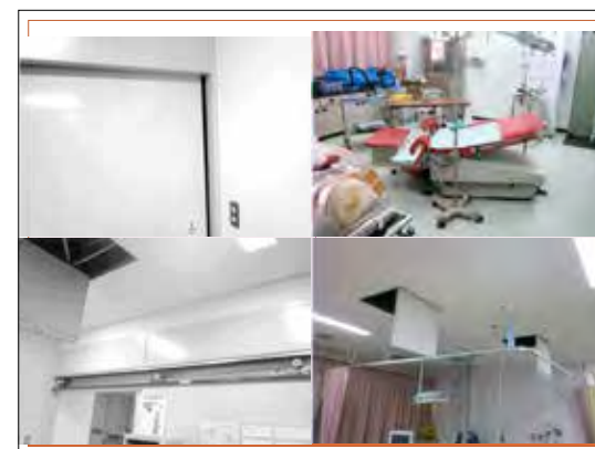
これが分娩室の被害状況です。分娩室の自動ドアはゆがんで開閉不能、分娩台がずれています。引き戸の上部が落下し、レールがむき出しになっています。分娩室の天井の点検口の蓋がすべて開きました。
